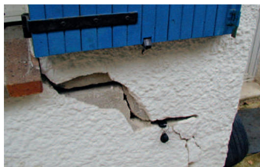
▲ Maison fissurée dans le Pas-de-Calais, août 2003. Sources : BRGM - P. Burchi
