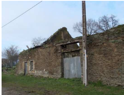
La Bourdonnaye : l'état du bâtiment ne permet plus d'envisager sa rénovation.
